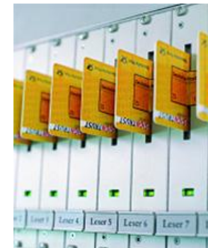
Massen-Einsatz an Server
